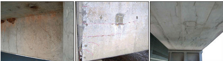
Gambar C.7 Ilustrasi kode kerusakan 202 Retak (elemen beton), dari kiri ke kanan kerusakan pada beton pratekan bertambah parah dan/atau volume semakin meluas (Wisconsin DOT, 2020)
