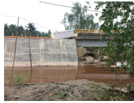
551 Kepala Jembatan atau pilar berdeformasi (settlement/ tilt/ movement)- Abutment guling
