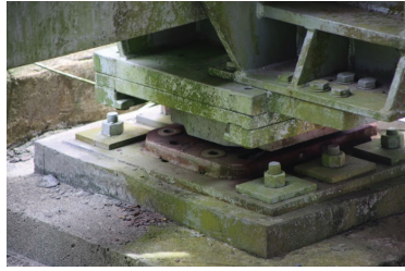
605 Bagian yang rusak atau hilang atau tidak berfungsi
