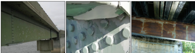
Gambar C.14 Ilustrasi kode kerusakan 301 Penurunan mutu dan atau kinerja proteksi korosi (lapisan pelindung / cat), dari kiri ke kanan kerusakan kehilangan keefektifan pengecatan bertambah parah dan/ atau volume semakin meluas (Wisconsin DOT, 2020)
