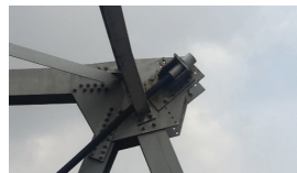
561 hilang atau rusak atau tidak berfungsi
