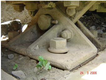
606 Bagian yang rusak atau hilang atau tidak berfungsi
