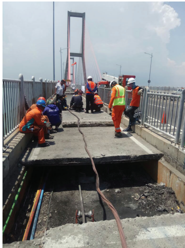
931 Tidak berfungsi utilitas karena terbakar
