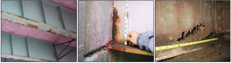
Gambar C.15 Ilustrasi kode kerusakan 302 Karat, dari kiri ke kanan kerusakan bertambah parah dan/atau volume semakin meluas (Wisconsin DOT, 2020)
