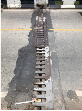
801 Kerusakan sambungan lantai yang tidak sama tinggi
