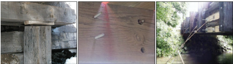
Gambar C.27 Ilustrasi kode kerusakan 405 Sambungan yang longgar, dari kiri ke kanan kerusakan bertambah parah dan/atau volume semakin meluas (Wisconsin DOT, 2020)
