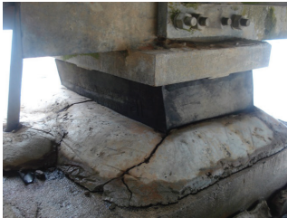
603 Mortar dasar retak atau rontok
