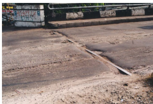
722 Permukaan yang kasar/berlubang (debonding, aus) atau retak
