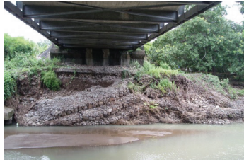
521 Pengikisan di sekitar jembatan ( local scour ) berupa berongong mengalami penurunan
