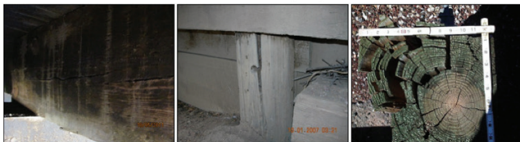
Gambar C.22 Ilustrasi kode kerusakan 401 Cacat pada kayu akibat lapuk, serangan serangga, sobek, kerusakan mata kayu, pecah, dari kiri ke kanan lapuk bertambah parah dan/atau volume semakin meluas (Wisconsin DOT, 2020)
