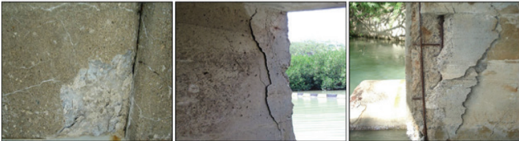
Gambar C.11 Ilustrasi kode kerusakan 205 Pecah atau hilangnya bahan (delaminasi, abrasi, aus) dari kiri ke kanan kerusakan berupa delaminasi bertambah parah dan/atau volume semakin meluas (Wisconsin DOT, 2020)
