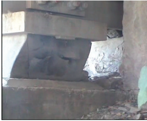
605 Landasan yang pecah, sobek atau retak
