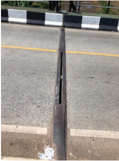
803 Bagian yang rusak/hilang
