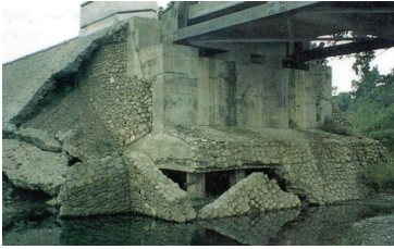
511 Bagian yang hilang atau tidak ada
