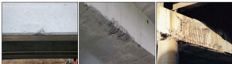
Gambar C.5 Ilustrasi kode kerusakan 201 Cacat pada beton dari kiri ke kanan kerusakan berupa gompal bertambah parah dan/atau volume semakin meluas (Wisconsin DOT, 2020)
