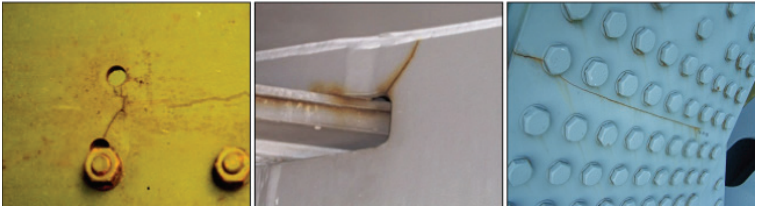
Gambar C.19 Ilustrasi kode kerusakan 304 Retak (elemen baja dan las), dari kiri ke kanan kerusakan bertambah parah dan/atau volume semakin meluas (Wisconsin DOT, 2020)
