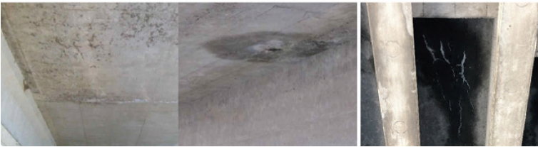
Gambar C.10 Ilustrasi kode kerusakan 204 Kotor, berlumut, penuaan atau pelapukan beton, rembesan, dari kiri ke kanan kerusakan yang terlihat dari perubahan warna yang terjadi bertambah parah dan/atau volume semakin meluas (Wisconsin DOT, 2020)
