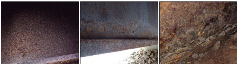
Gambar C.13 Ilustrasi kode kerusakan 301 Penurunan mutu dan atau kinerja proteksi korosi (lapisan pelindung / cat) , dari kiri ke kanan kerusakan berupa degradasi film oksida dan tekstur bertambah parah dan/atau volume semakin meluas (Wisconsin DOT, 2020)
