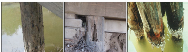
Gambar C.21 Ilustrasi kode kerusakan 401 Cacat pada kayu akibat lapuk, serangan serangga, sobek, kerusakan mata kayu, pecah, dari kiri ke kanan lapuk bertambah parah dan/atau volume semakin meluas (Wisconsin DOT, 2020)
