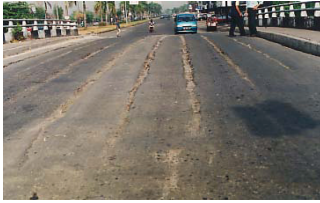
701 Pergerakan yang berlebih arah memanjang sambungan akibat lepasnya kabel prategang lateral pada jembatan voided slab
