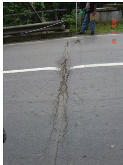
805 Retak aspal akibat pergerakan sambungan (type Asphaltic Plug Joint)
