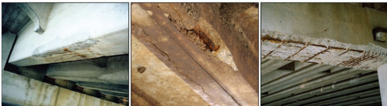
Gambar C.8 Ilustrasi kode kerusakan 203 Karat baja tulangan, kerusakan berupa tulangan yang terekspos dari kiri ke kanan kerusakan bertambah parah dan/atau volume semakin meluas (Wisconsin DOT, 2020)
