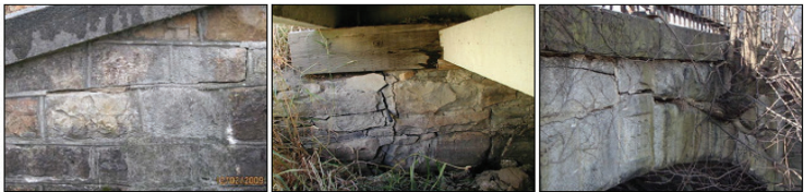
Gambar C.3 Ilustrasi kode kerusakan 103 Bagian yang pecah atau hilang (mortar, batu) dari kiri ke kanan, kerusakan bertambah parah dan/atau volume semakin meluas (Wisconsin DOT, 2020)
