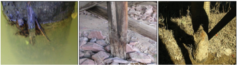
Gambar C.25 Ilustrasi kode kerusakan 402 Komponen yang rusak atau hilang (termasuk retak, delaminasi), dari kiri ke kanan abrasi bertambah parah dan/atau volume semakin meluas (Wisconsin DOT, 2020)
