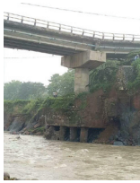
551 Kepala Jembatan atau pilar berdeformasi (settlement/tilt/ movement)- Pilar Turun/Settle
