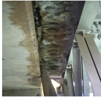
804 Bagian yang rusak/hilang
