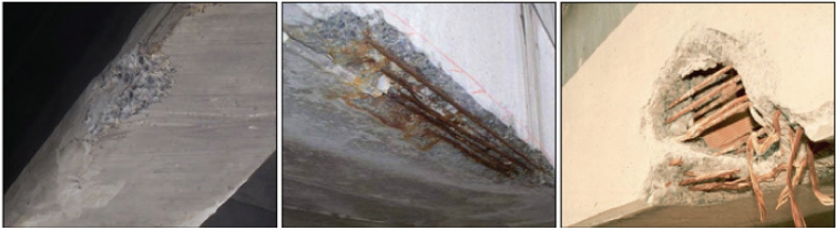
Gambar C.9 Ilustrasi kode kerusakan 203 Karat baja tulangan, kerusakan berupa tulangan prategang yang terekspos dari kiri ke kanan kerusakan bertambah parah dan/atau volume semakin meluas (Wisconsin DOT, 2020)
