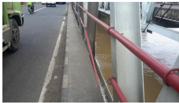
931 Tidak berfungsi karena tidak membentuk suatu struktur yang utuh untuk mengamankan pengguna jalan
